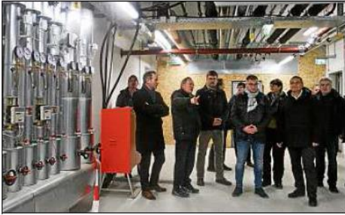
Nach dem Richtfest gab es einen Einblick in die Technik des sanierten und umgebauten Hauses. Foto: Claudia Bachmann
