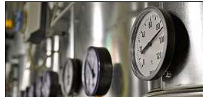
Die bereits installierte Anlage zur Warmwasseraufbereitung im Keller des künftigen Technikgebäudes. Foto: ÖHK
