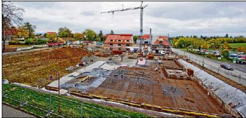
Die Baugrube für die neue Küche und das Patientencafé des Ökumenischen Hainich-Klinikums in Pfaferode ist bereits ausgehoben. In drei Wochen, am 9. November, soll der offizielle Grundstein für den Neubau gelegt werden. Fotos: Daniel Volkmann (4)
